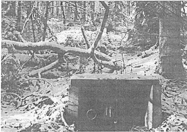
Abb.5: Quellsammelschacht der Steinachquelle mit Überlauf (Froschklappe) und Drainagerohr.
